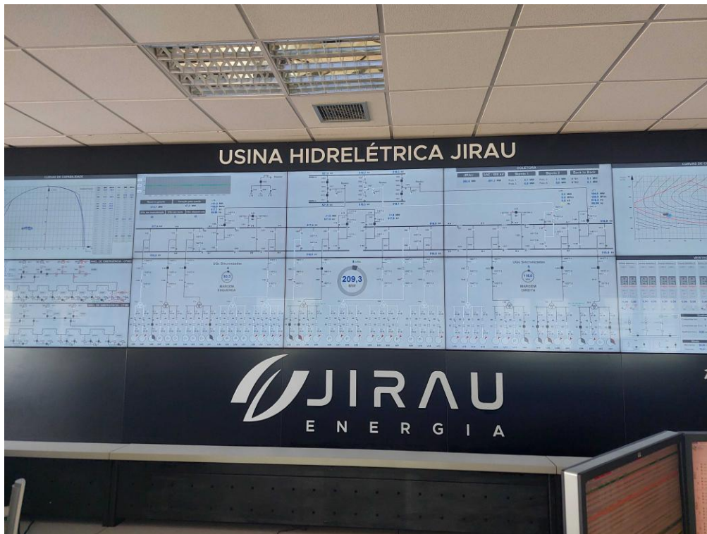
VideoWall da Sala de Controle
