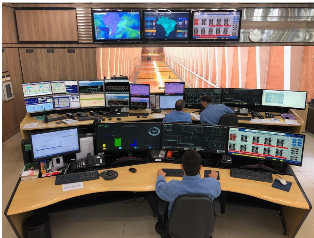
Centro de Operações da Geração (COG) da Enel
